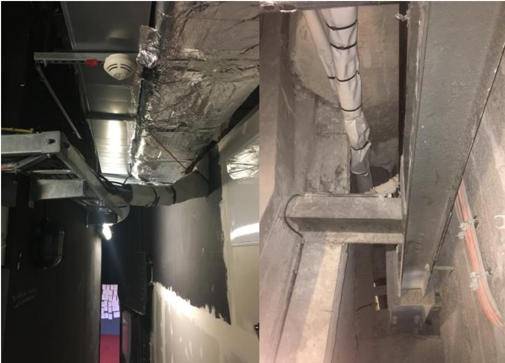
4: Lüftungskanäle (re.) und Leitungen (li.)
