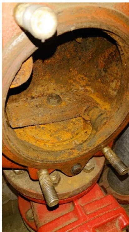
Foto vom 13.11.2019, Sprühflutventil 1 Eiserner Vorhang Hauptbühne
